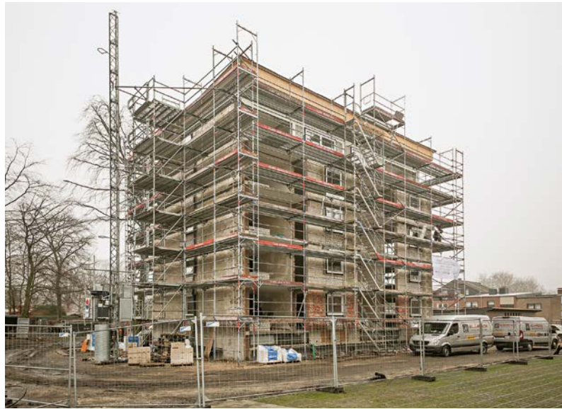
Durch eine Bestandsanalyse wurde am Gebäude im Akazienweg ein deutlicher Sanierungsbedarf erkannt, worauf eine Kernsanierung folgte. Nun sollen ähnliche Sanierungsschritte bei allen Gebäuden folgen
